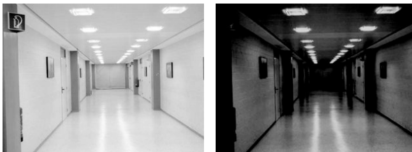
Afbeelding J.11.5-3: Gang met nalichtend materiaal in de TL-armaturen, links met de normale verlichting brandend, rechts bij uitgevallen verlichting. Foto: Stell Sign-Projects B.V.
